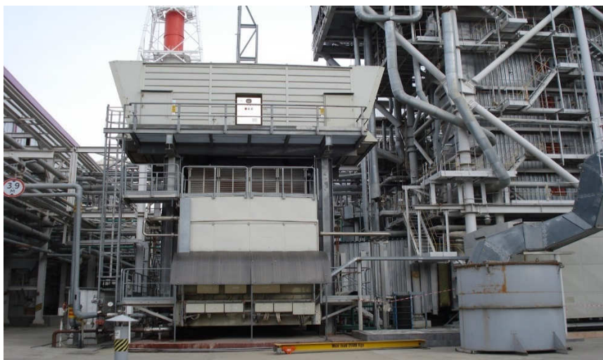
Рис. 2.1. КБОУ ГТУ Siemens GT-10C на Сочинской ТЭС [2]
