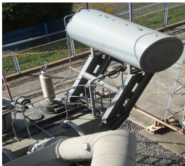
Рис. 5.37. Масло на поверхности силового трансформатора под маслобаком
