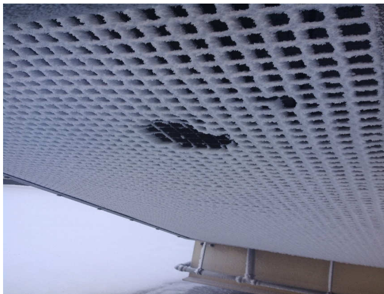
Рис. 2.54. Обмерзание защитной сетки от птиц КВОУ ГТУ
