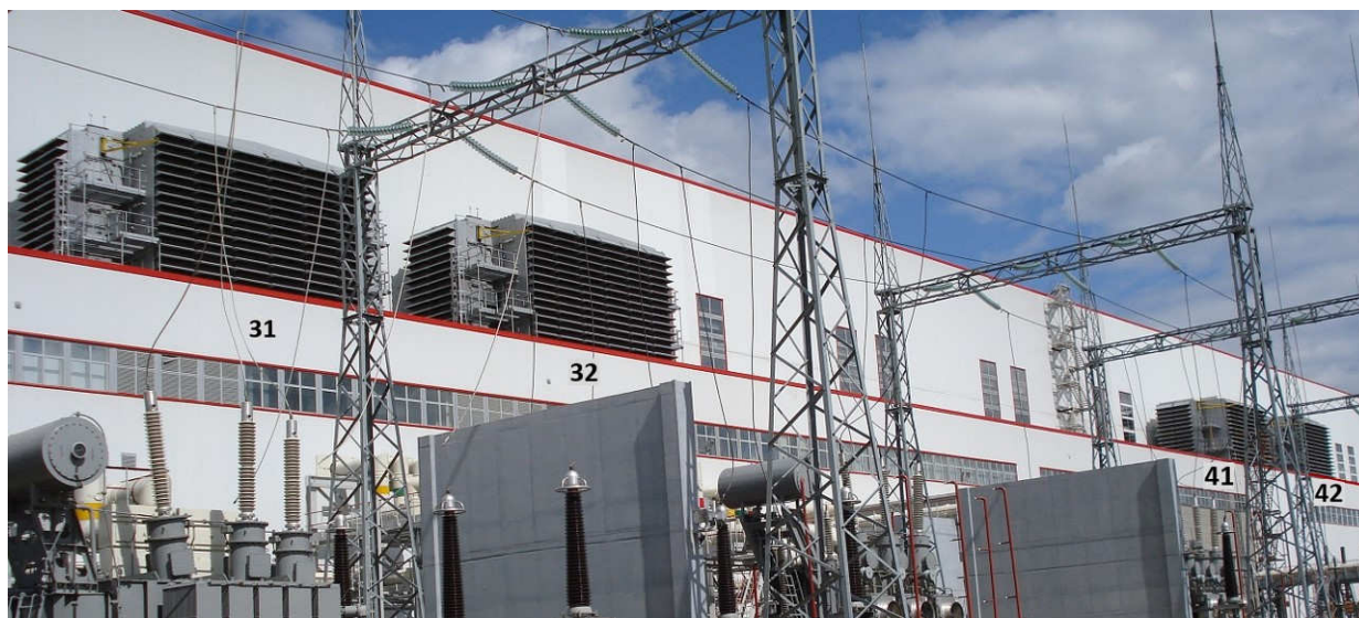
Рис. 5.19. КВОУ 31 и 32 энергоблока № 3 и КВОУ 41 и 42 энергоблока № 4 ТЭЦ в МО
