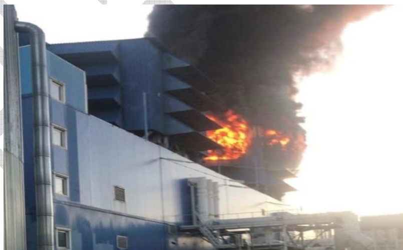
Рис. 1.19. Пожар на КВОУ Ивановских ПГУ
