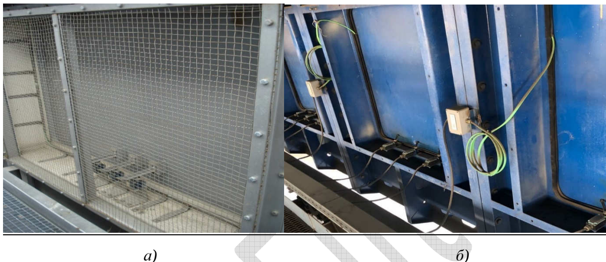
Рис. 3.40. Байпасный клапан: а) конечные выключатели и защитная сетка от птиц; б) кабель обогрева уплотнений между люками байпасных клапанов и корпусом КВОУ
