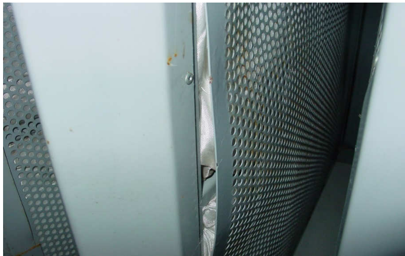
Рис. 1.5. Дефекты глушителя шума
