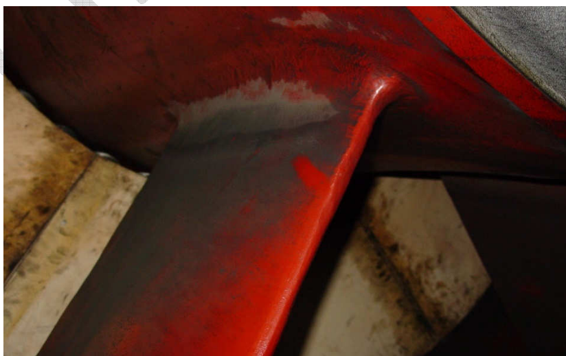
Рис. 1.6. Отложения на входном коке компрессора ГТЭ-160
