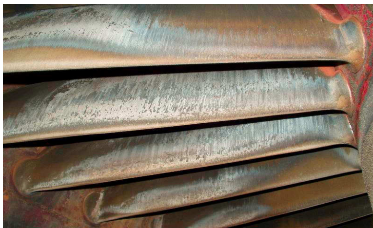
Рис. 3.4. Эрозийный износ лопаток компрессора ГТУ V94.2А
