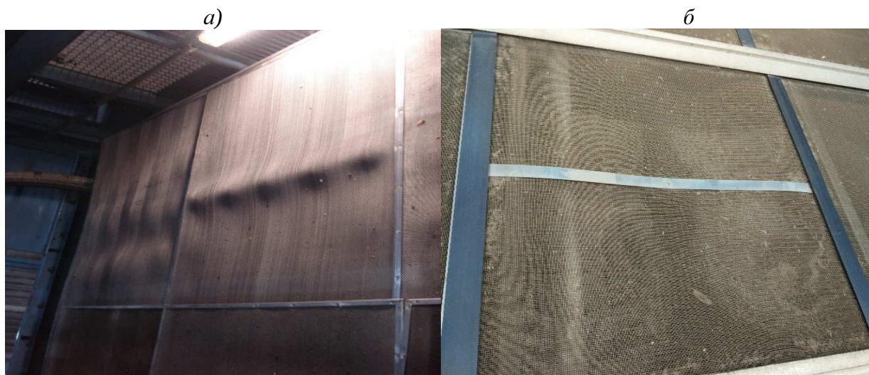
а) б) в) г) Рис. 2.40. Конструктивные неисправности противомоскитных сеток: а) ржавление металла; б), в) деформация металла; г) двойная сетка [9]
