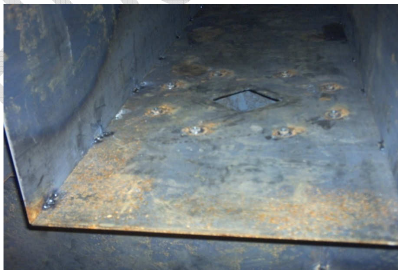
Рис. 1.16. Внутреннее состояние короба ПОС КВОУ
