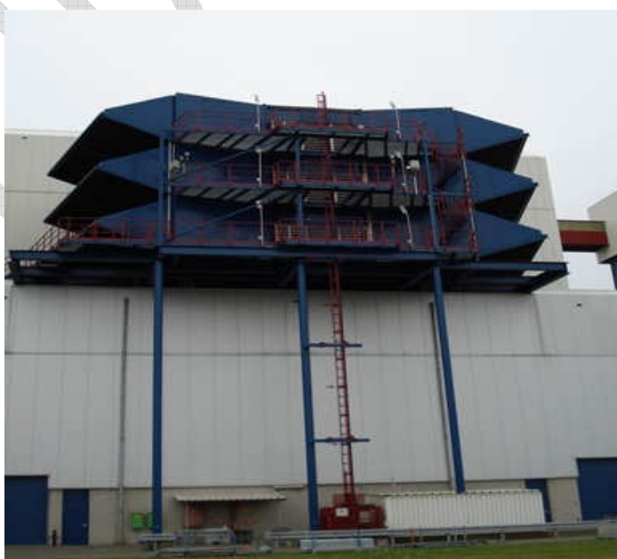
Рис.2.6. КВОУ компании Merrem & la Porte на ТЭЦ Delesto [3]
