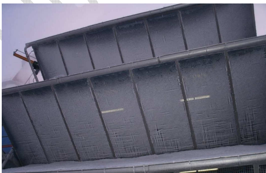
Рис. 2.49. Обмерзание защитных сеток от птиц и мусора КВОУ ГТУ Яйвинской ГРЭС [15]
