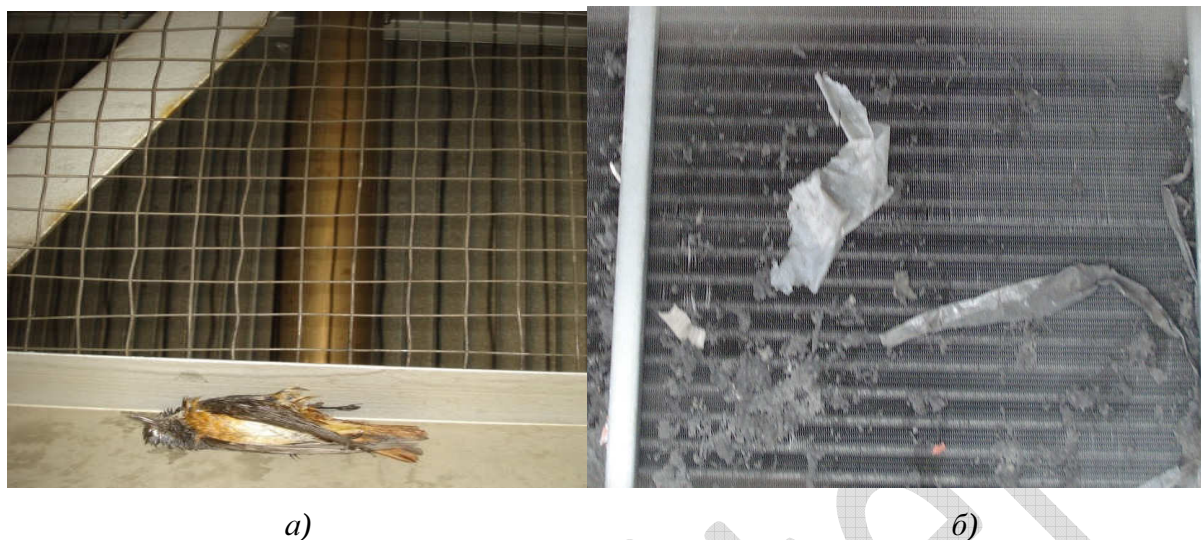
Рис. 2.42. Защитная сетка от птиц и мусора КБОУ ГТУ: а) предотвращение попадания птицы; б) загрязнение теплообменного аппарата мусором при повреждении сетки
